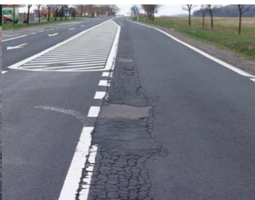
Fessurazione da fatica
